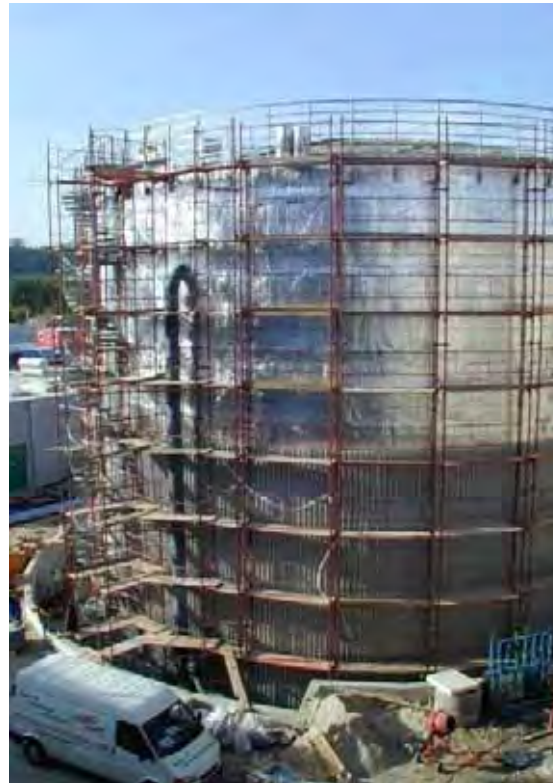
Isolierung für die Speicherung von Warmwasser
