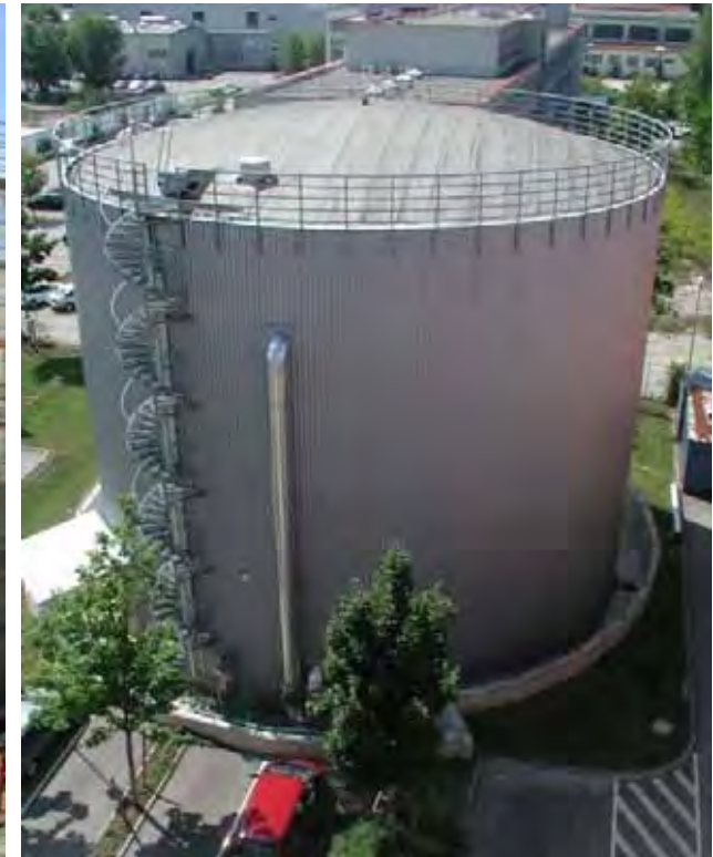
Wärmespeicher für 5.000m 3
