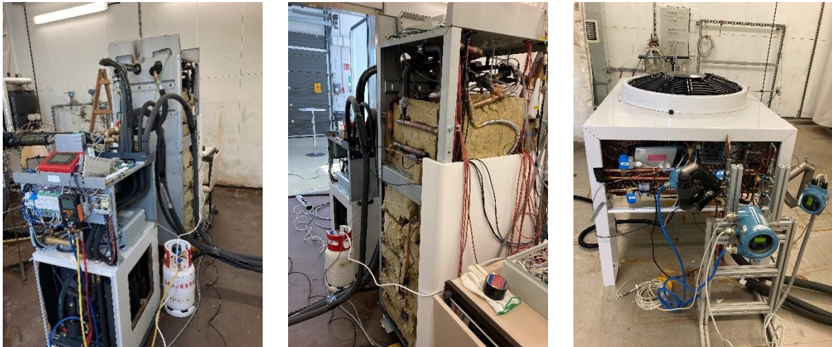
Abbildung 9: CHALLENGE- Funktionsmuster in den Klimakammern des AIT-Labors. Links: Inneneinheit. Mitte: Speichereinheit. Rechts: Außeneinheit. Quelle: AIT
