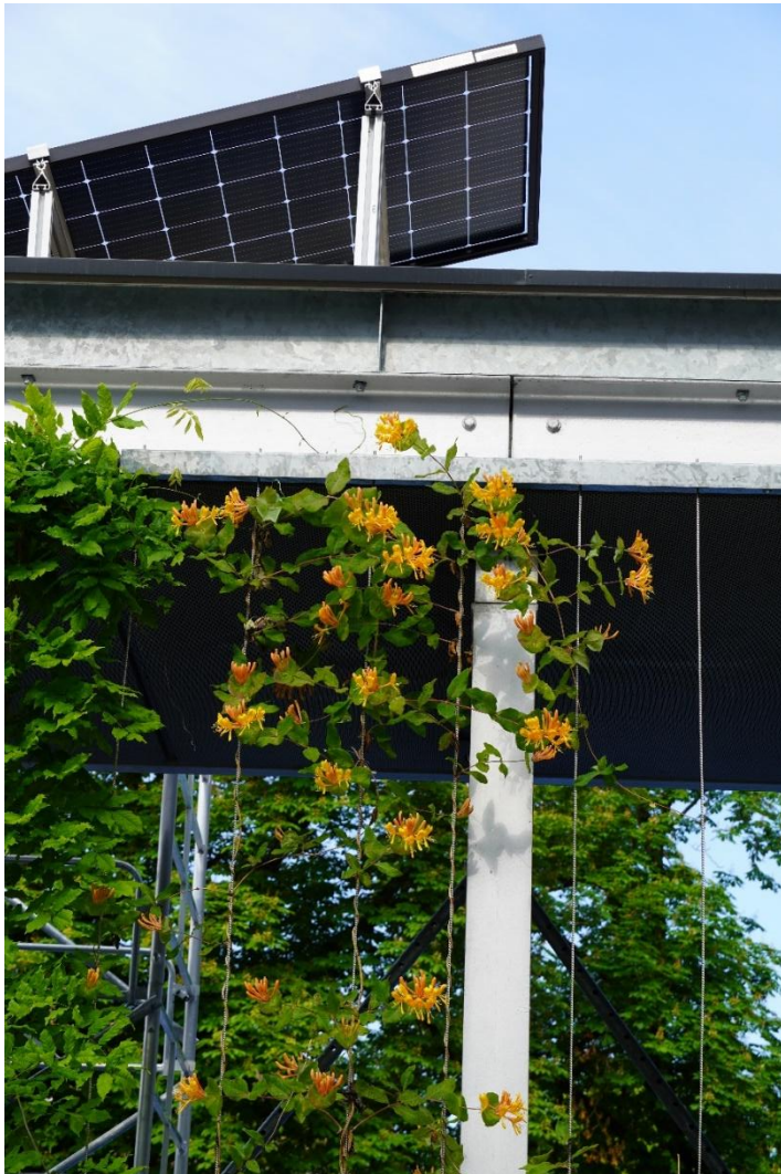
Abbildung 59: Blühende Kletterpflanzen unter dem Bachlauf mit Photovoltaiküberdachung zu Projektende (Foto: Zluwa, GRÜNSTATTGRAU)
