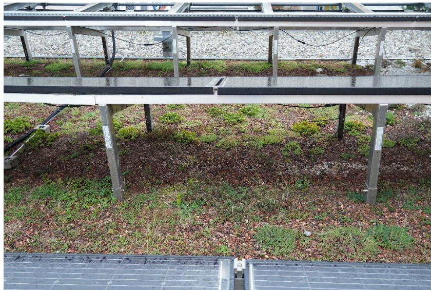
Abbildung 18: Aufgeständerte Module mit Sedumbepflanzung (Foto: Zluwa, GRÜNSTATTGRAU)
