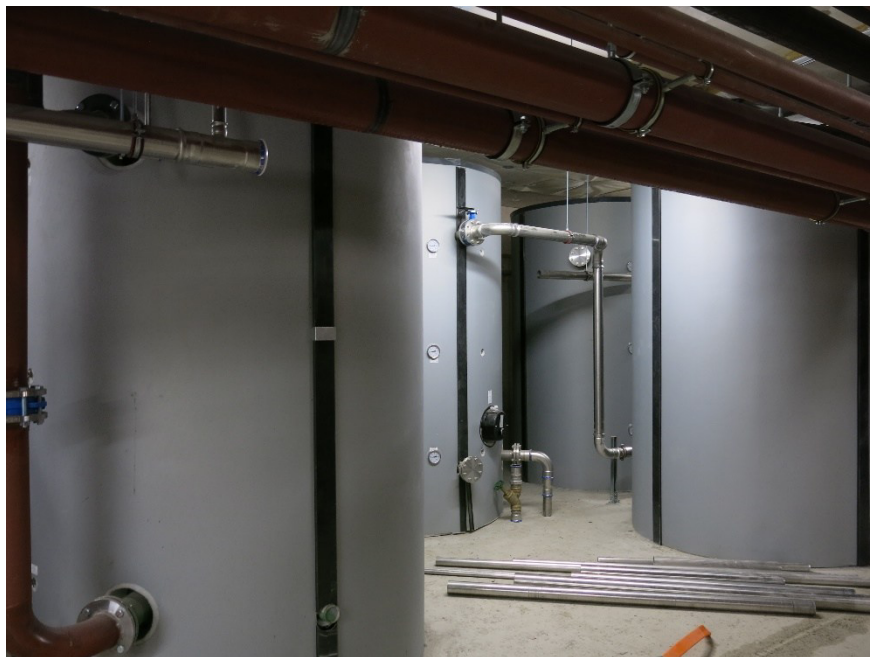
Abbildung 10: Technikraum mit Wärmespeichern (Bildnachweis: Schöberl & Pöll GmbH)
