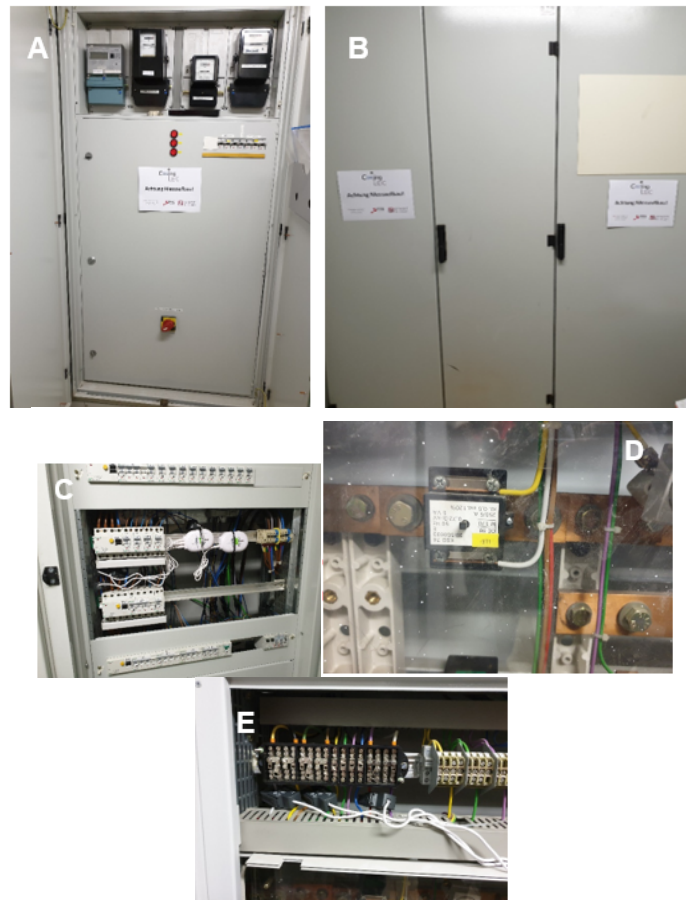
Abbildung 6: Messaufbau für die Erfassung der Verbräuche beim Demonstrationsgebäude Planungsbüro – (A): Hinweis Messung Schaltschrank 1, (B): Hinweis auf die Messung Schaltschrank 2, (C) Detailaufnahme Messgeräte, (D) Messwandler, (E) Detailaufnahme Messklemmen
