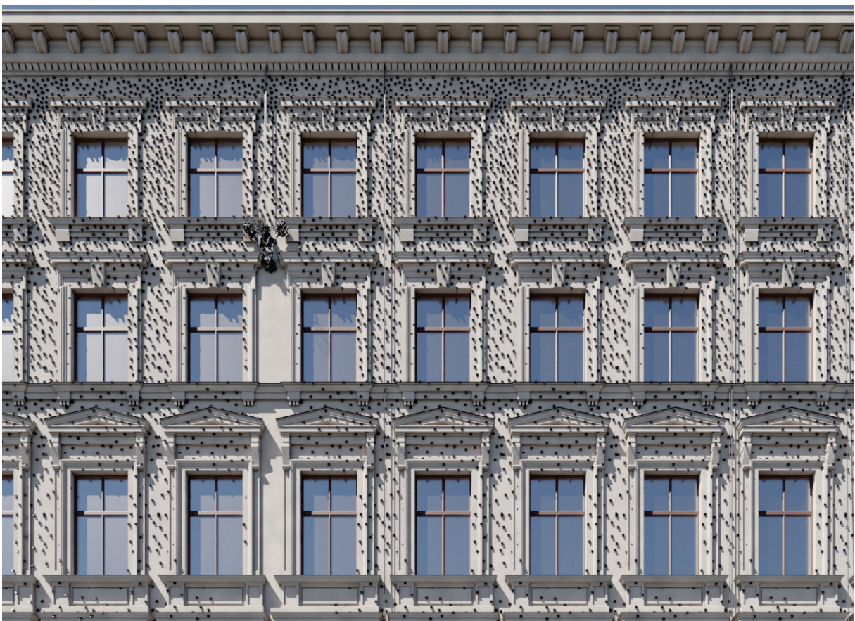
Abbildung 81: 2022, Renovierung, Fassade mit aktiven Photovoltaik-Modulen
