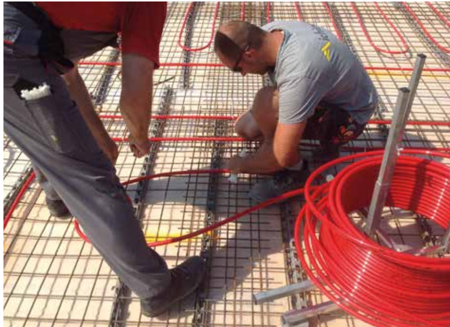
Abb. 3 | Der Einbau von Heiz- und Kühlregistern in die Decke ist rasch, unkompliziert und damit kostengünstig möglich. © Aichinger Hoch- u. Tiefbau GmbH
