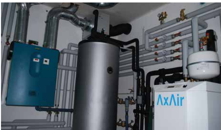
Abb. 24 | Die Energiezentrale mit Wärmepumpe, Warmwasserspeicher, Umwälzpumpe und Verteilerleitungen etc. ist übersichtlich auf kleinstem Raum zusammengestellt.
