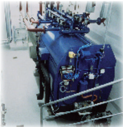
Abbildung 11: Adsorptionskältemaschine im Universitätsklinikum Freiburg (Quelle: Fraunhofer ISE)
