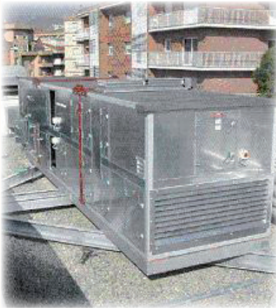
Abbildung 15: Sorptionsgestützte Klimatisierung in Außenaufstellung auf dem Dach der Bibliothek in Matarò (Quelle: FH Stuttgart)
