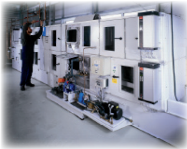
Abbildung 5a: Prüfstand zur solaren Klimatisierung (Quelle: Fraunhofer ISE/Freiburg)
