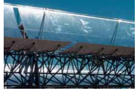
© Eurotrough – Plataforma Solar de Almeria, Parabolrinnenkollektor
