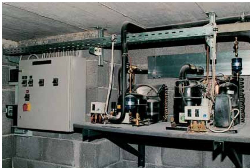
Richtige Einstellung und Wartung von Kühlaggregaten und Nutzung der Abwärme.
