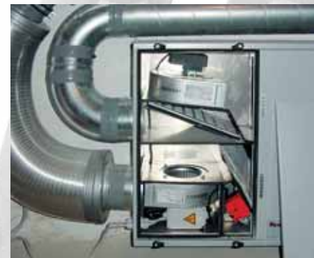
Ventilatoreinheit eines Lüftungsgerätes.
