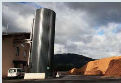
Biomasseheizwerk Saalfelden, Foto: Klima- und Energiefonds/Krobath
