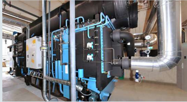
Absorptionswärmepumpe Hallein, Foto: Klima- und Energiefonds/Krobath
