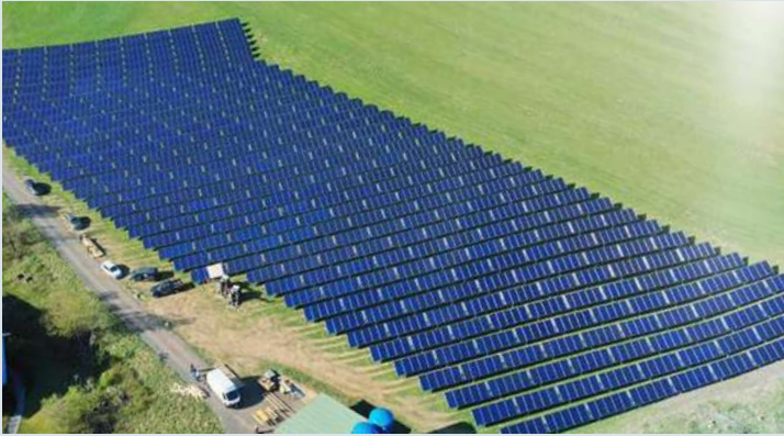
Großsolarthermie Mürzzuschlag, Foto: SOLID Solar Energy Systems GmbH
