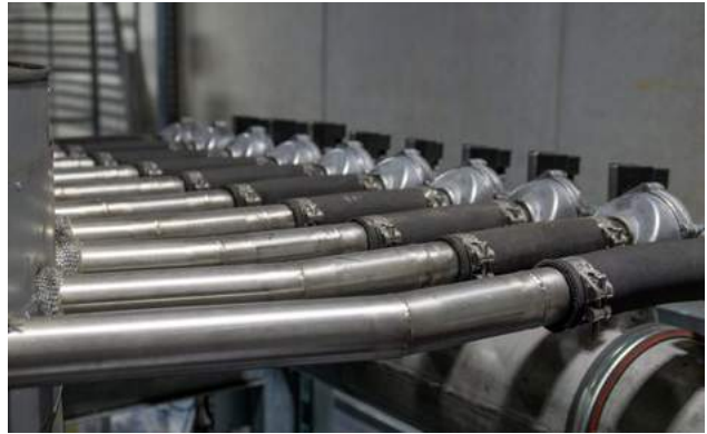
Holzgas-KWK-Anlage: Holzgasaufbereitung mittels Heißgasfiltration, Foto: BEST / Lagler
