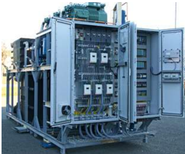
Photo: Frigopol Kälteanlagen GmbH
