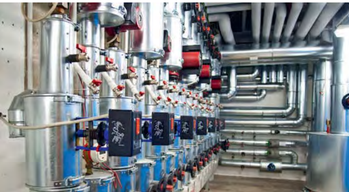
Fernwärme Hausanschluss, Quelle: Ashkan Nasirkhani, fotolia.de
