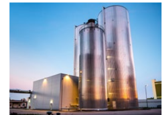
Hochdruck-Wärmespeicher am Gelände des Kraftwerks Simmering, Foto: Wien Energie/Ian Ehm
