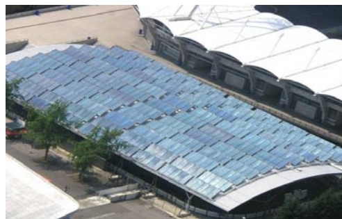
Abbildung 35: Einspeisung von Solarwärme ins Grazer Fernwärmenetz durch das steirische Unternehmen S.O.L.I.D. und der Energie Graz
