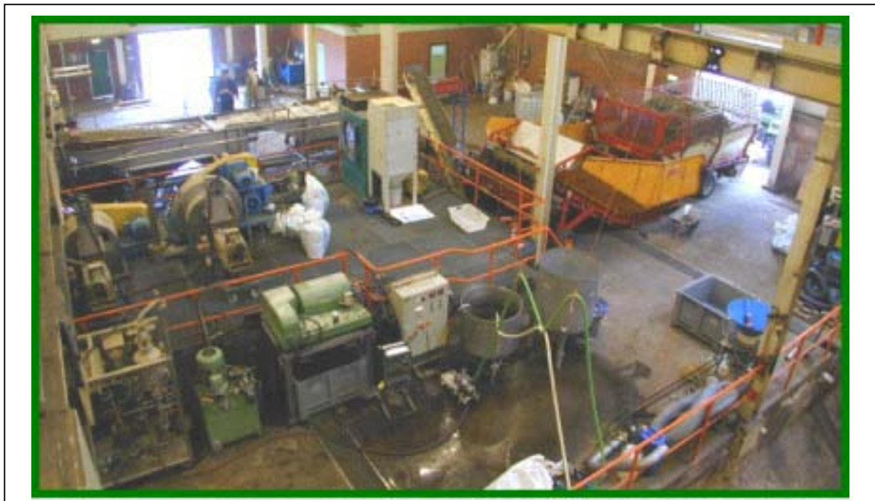
Abb. 1-4: Bioraffinerie – Pilotanlage der niederländischen Firma AVEBE in Foxhol (NL) [ Hulst 2002 ].
