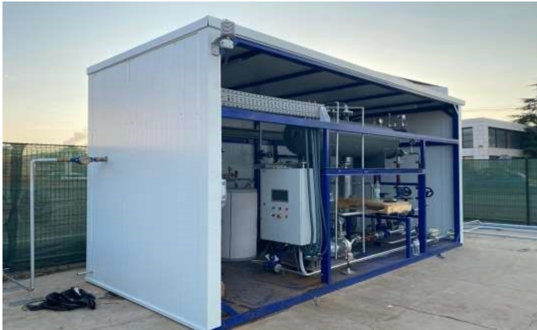
Abbildung 5-15: Container-Lösung für das von SOLATOM entwickelte Integrationskonzept – dargestellt in Abbildung 5-14 vgl. (Zarza et al., 2022).
