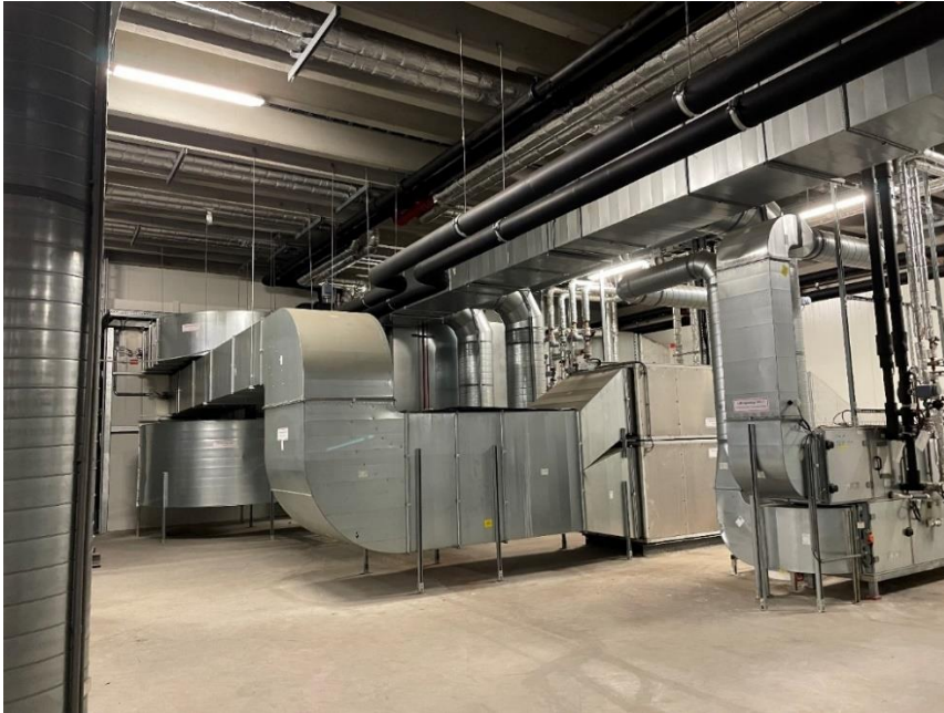
Abbildung 3: Lüftungsanlage bei Coca-Cola HBC Österreich
