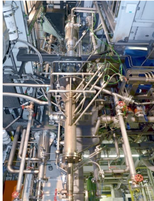
Abbildung 21: 80 kW Pilot Anlage an der TU Wien für Chemical Looping Combustion.
