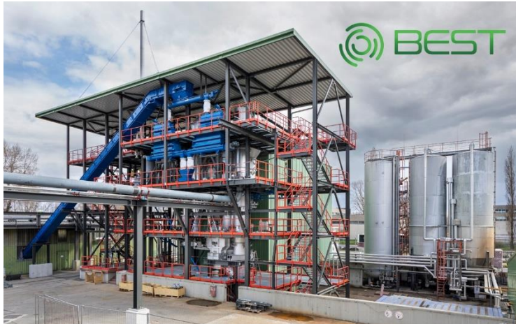
Abbildung 10: Der 1 MW DFB Gaserzeuger der Syngas Plattform Wien
