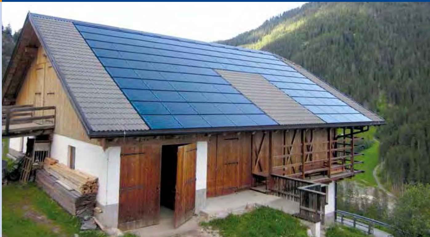
Fig. 3 - 20 kWp PV plant at Badia (BZ), Monocrystalline modules (Photo: GSE, Gestore dei Servizi Energetici).
