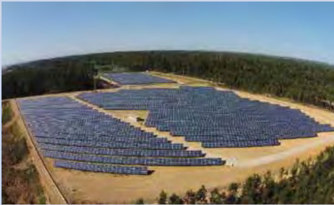
Fig. 2 - EDP Renováveis - Estarreja PV Plant - 2 MW.
