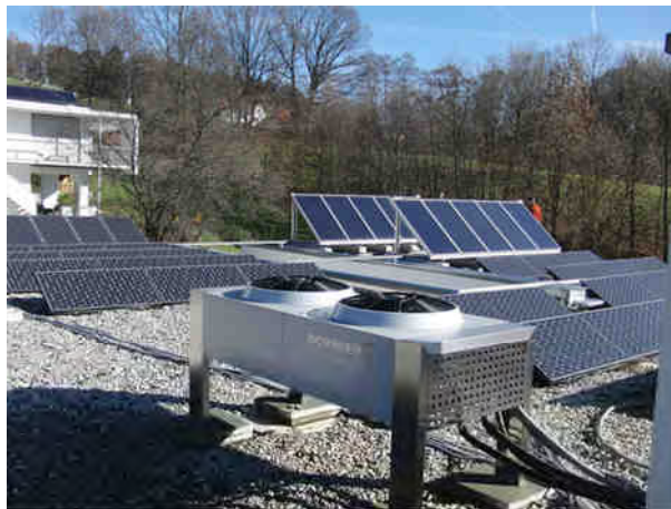
Abbildung 1: Solarthermische Kollektoren und Außeneinheit einer Luft/Wasser-Wärmepumpe sowie Photovoltaikpaneele auf einem Flachdach eines Einfamilienhauses
