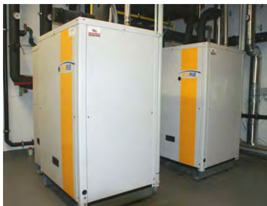
Abbildung 3-19: Foto der installierten AWP
