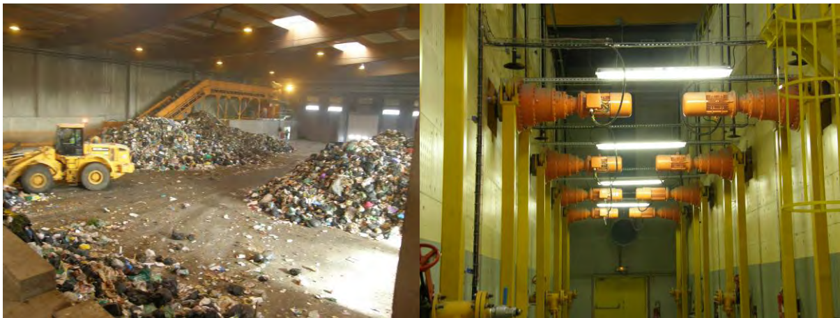
Abb. 1: Linde Bioabfallbehandlungsanlage in der nordfranzösischen Stadt Lille mit Abfallannahme (links) und Gärreaktoren (rechts)
