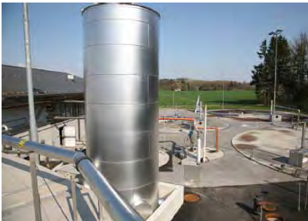
Abb. 15: Biogasanlage zur Behandlung stickstoffreichen Schlachthofabwassers mit Entschwefelungskolonne (Vordergrund)
