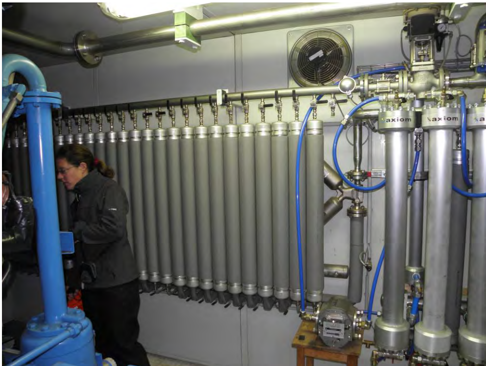
Abb. 9: Membranaufbereitung von Biogas auf Erdgasqualität mit Detailansicht der Membran – Rohrmodule
