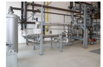
Foto: Institut für Thermodynamik und Energietechnik, TU Wien
