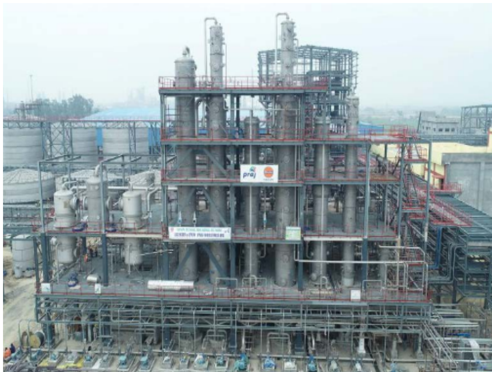
Abbildung 1: 2G-Ethanol-Anlage in Panipat, Indien 1
