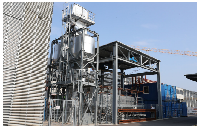
Aktiver Wirbelschichtspeicher „sandTES“ des Instituts für Thermodynamik und Energietechnik (TU Wien). © Institut für Thermodynamik und Energietechnik, TU Wien
