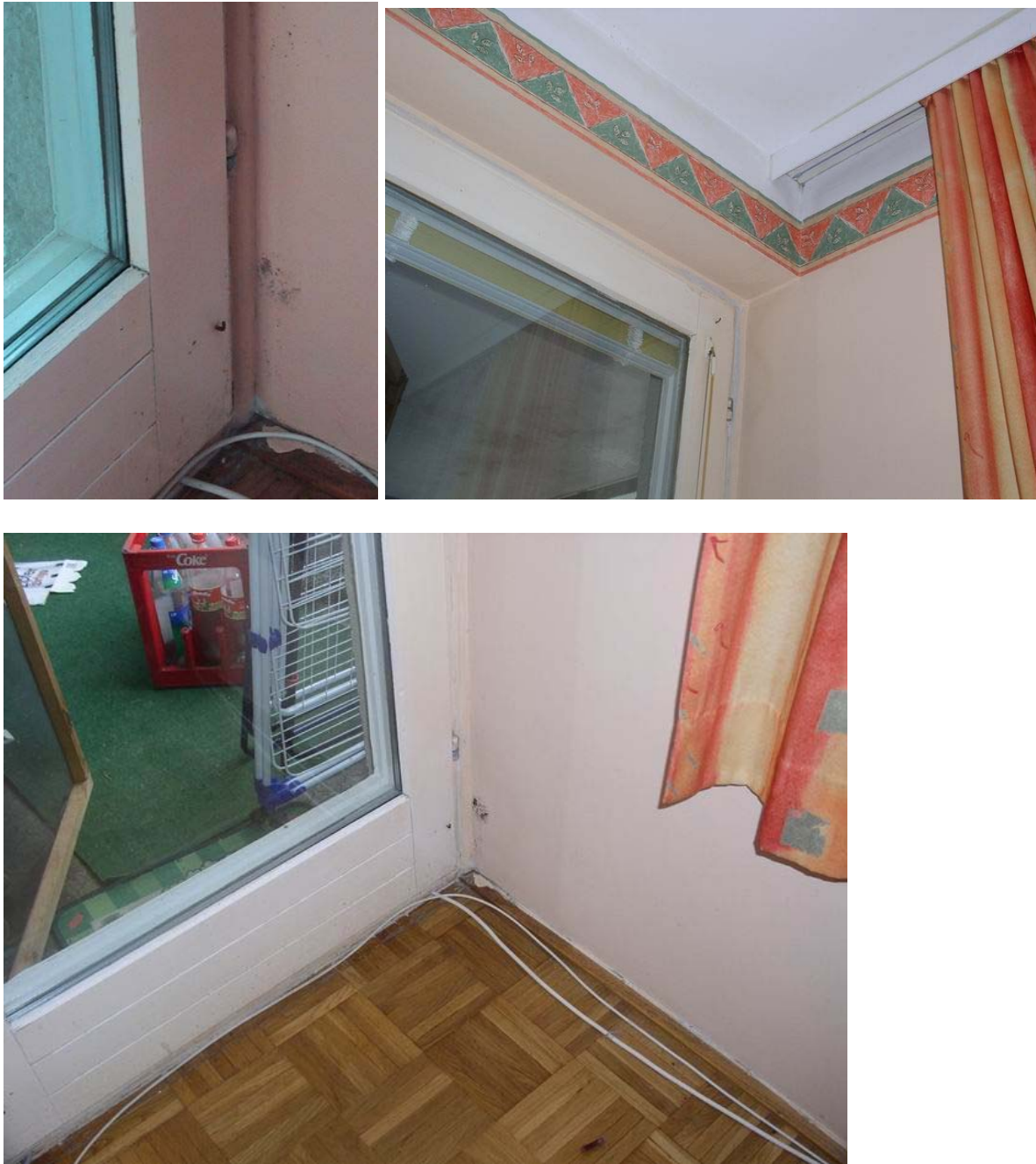
Bild 2 Flecken bzw. Schimmelbildung an der Ecken der Außenwand
