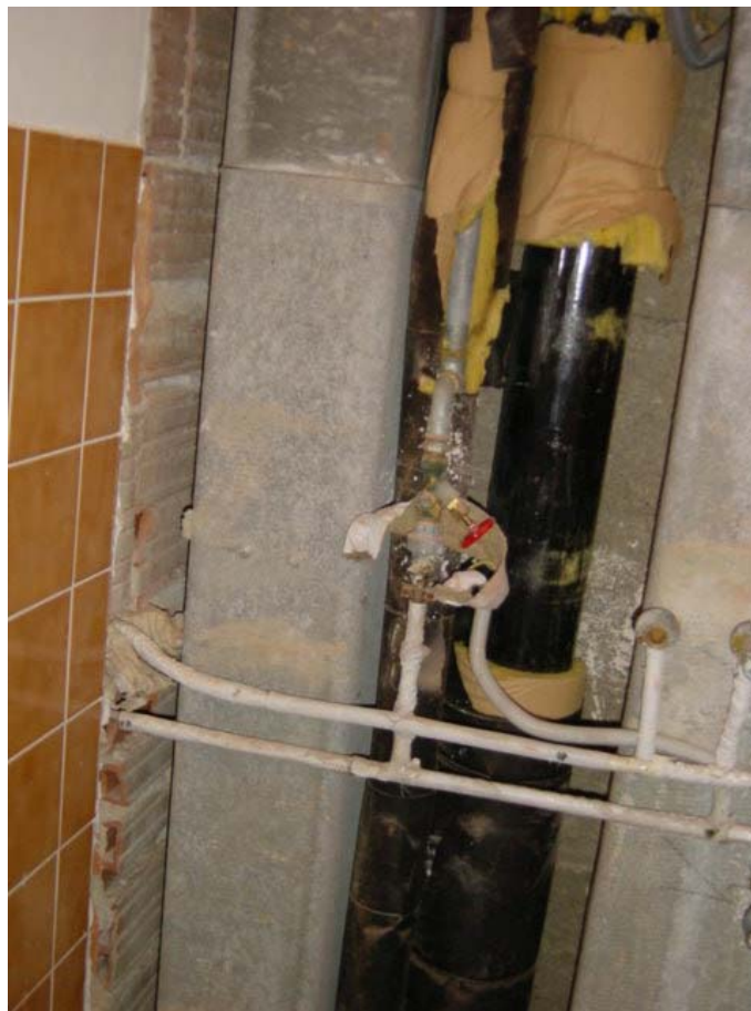
Zuleitungen zum Elektrodurchlauferhitzer
