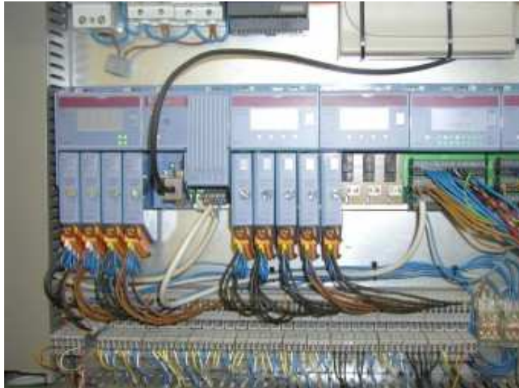
Abbildung 5: Eingebautes Loggersystem im EBS Haus 1, Solarcity Linz
