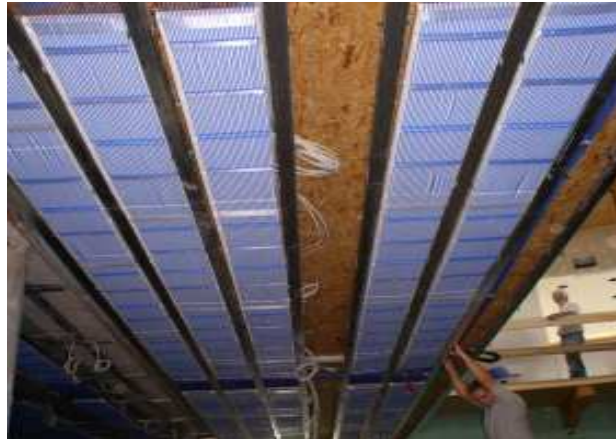
Abb. 17: Heiz- und Kühldecken (Produkt „RCS“) im ChristophorusHaus
