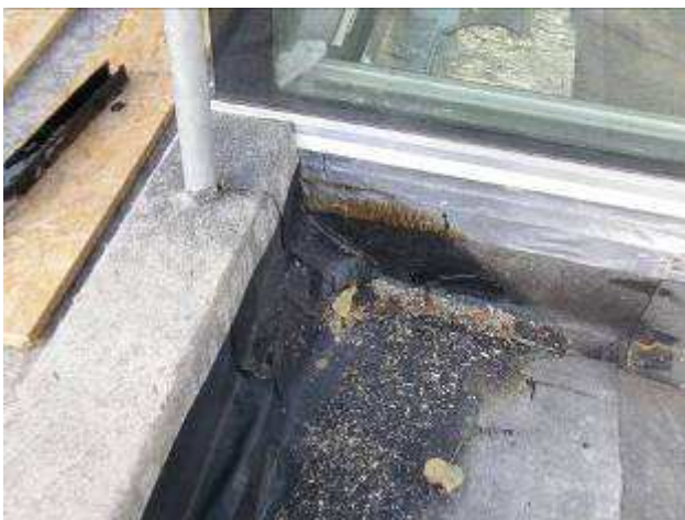
Mangelhaft ausgeführtes Eckdetail. Sämtliche Ecken sind rechtwinkelig und ohne Erhebungen herzustellen.
