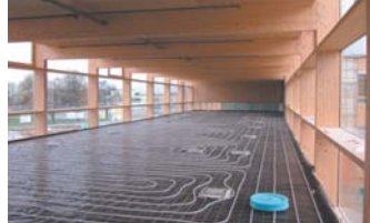
Fußbodenheizung in der Bibliothek | Floor heating in the library
