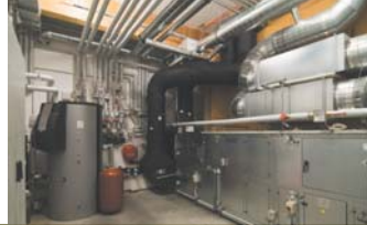
Lüftungswärmetauscher, Technikraum | Ventilation heat exchanger, service room
