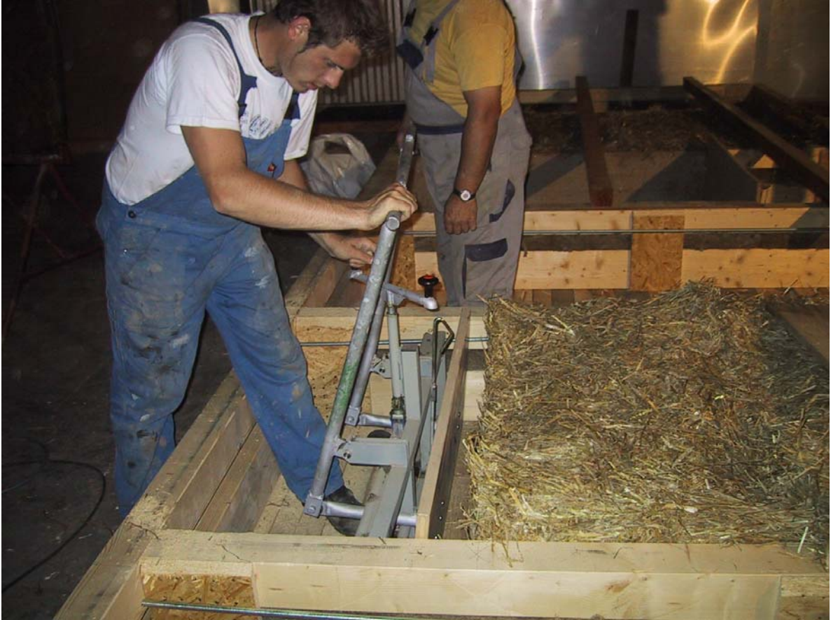
Bild B: Stroh-Einbau mit Großballen-Teilen. Der Naturdämmstoff Stroh ist in großen Mengen verfügbar und kostengünstig, jedoch relativ leicht biologisch abbaubar. Daher ist das Risiko von Bauschäden durch Fehler in der Konstruktion, in der Logistik oder in der Ausführung gegenüber der Verwendung anderer Dämmstoffe relativ höher.
