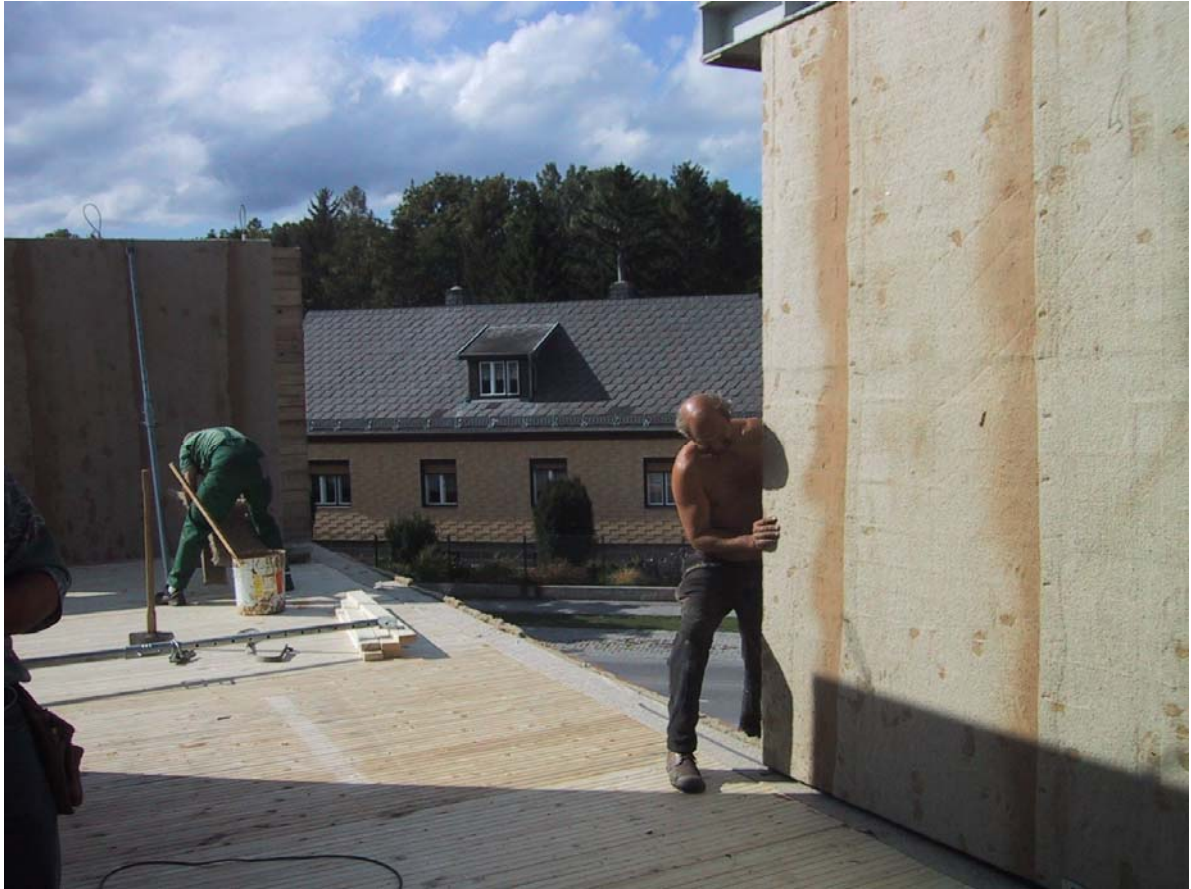
Bild 8: Präzises Versetzen und Verkleben der Module mit Lehm-Vliestechnik. Zusätzlich wurden beim ersten Einsatz hier konventionelle Quellbändern eingesetzt.
