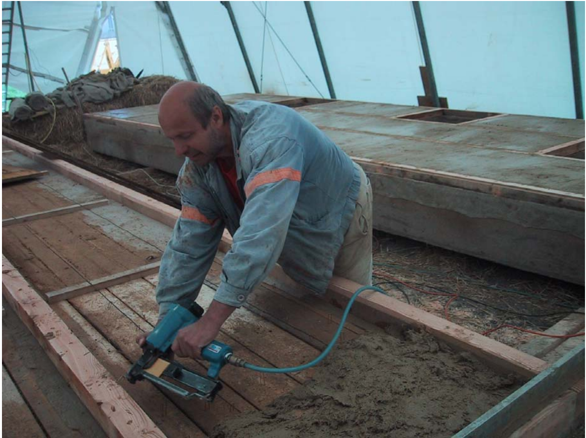
Bild G: Zweilagige Beschichtung der Wandmodule mit Biofaserlehm BFN03 und 02 A. Mikrobielle statt chemischer Stabilisierung ermöglicht den Einsatz von Lehmbaustoff auch an bewitterten Außenwänden. Im Hintergrund ein bereits fertig beschichtetes Außenwand-Modul.
