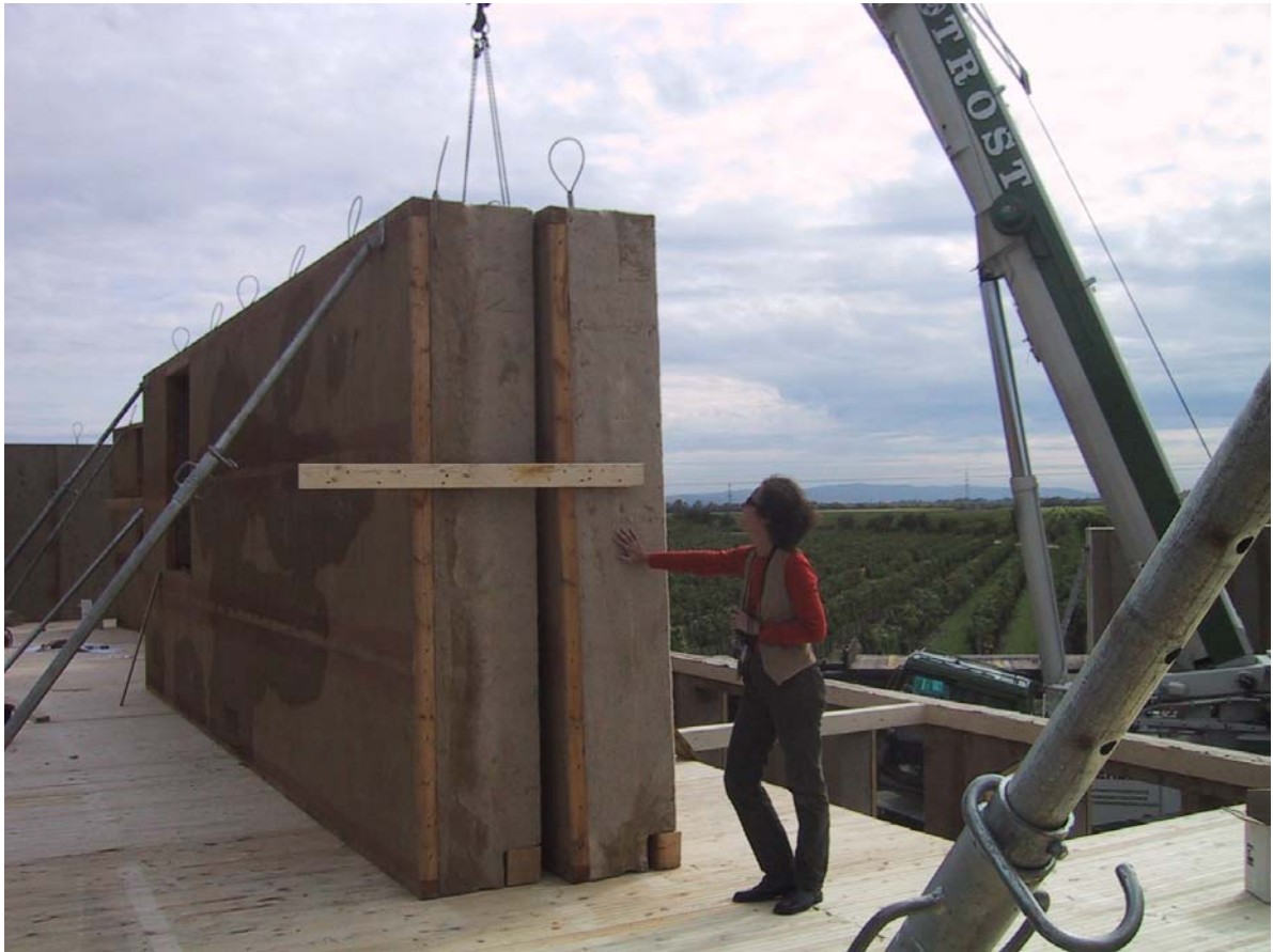
Bild 7: Arch. Martha Enriquez-Reinberg dokumentiert die Montage auf der Baustelle und betrachtet die Lehm-Vlies Oberfläche der Modulstöße.
