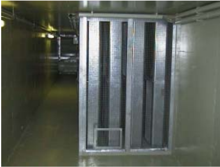
Abbildung 99: Bypasskanal mit Ventilator
