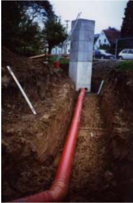
Abbildung 93: Ansaugturm und ein PVC-Rohr. Die acht parallelen PVC-Rohre weisen eine Nennweite von 400 mm auf. Die Verlegetiefe der Rohre beträgt im Mittel 2 m.
