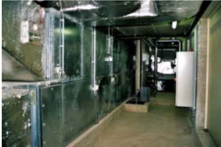
Abbildung 7: Häufig werden L-EWT als Vorstufe von zentralen Lüftungsanlagen eingesetzt
