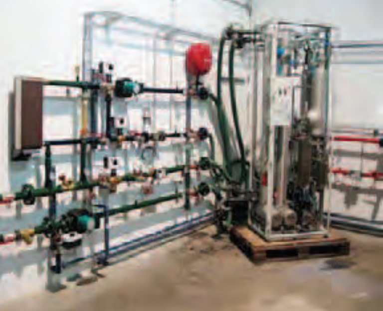
▲ Abbildung 2 Prüfstand für thermisch angetriebene Kältemaschinen und Wärmepumpen bei Pink
