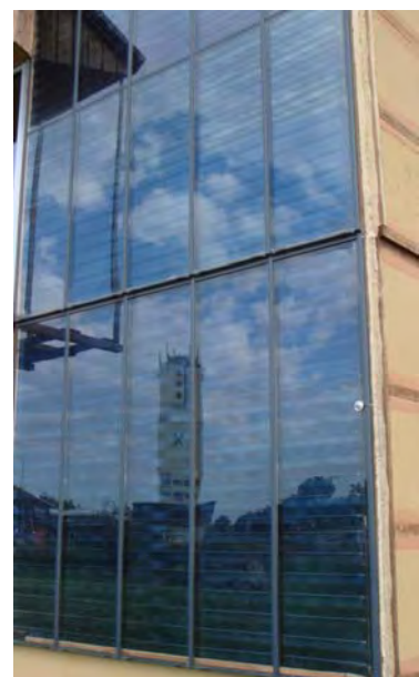
Fassadenkollektor auf der Südseite des Gebäudes
