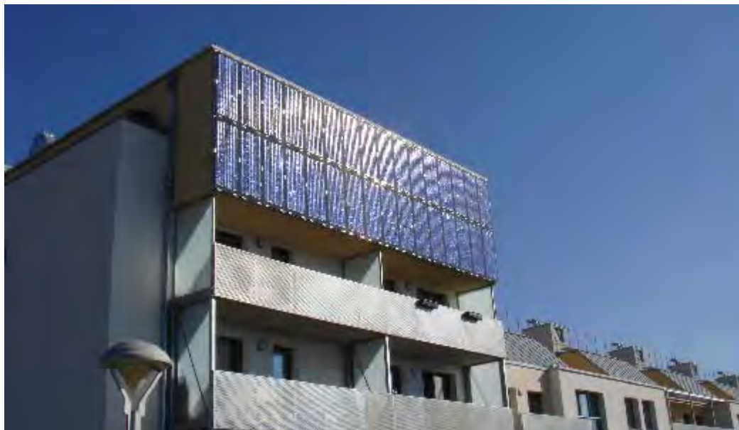
Abbildung 7: Die Photovoltaikanlage auf der Südfassade der Wohnanlage
