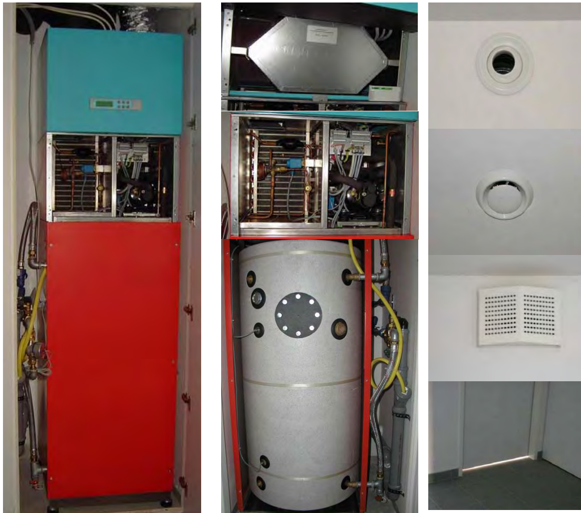
Abbildung 11: links, mitte: Kompaktlüftungsgerät vom Typ Aerosmart S der Firma Drexel&Weiss; rechts: Zu-, Abluft- und Überströmöffnungen [AEE INTEC]
