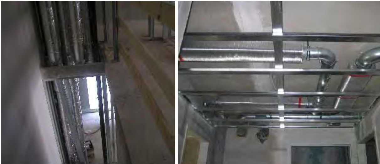
Abbildung 9: Sammelschacht für die Zu- und Abluftleitungen und Luftverteilung in abgehängten Decken [DI Wilhelm Hofbauer]
