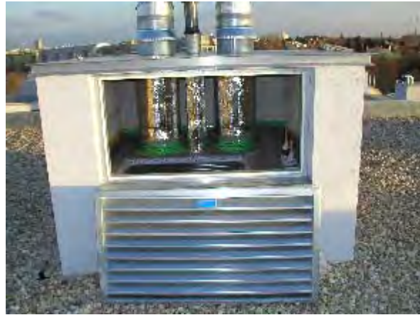
Luft Ein- und Auslasskanäle über Dach Quelle: AEE- INTEC
