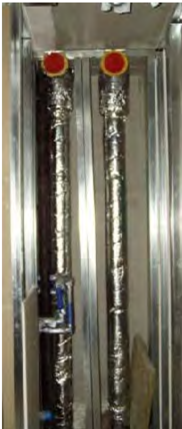
Installationen für die Wohnraumlüftung
