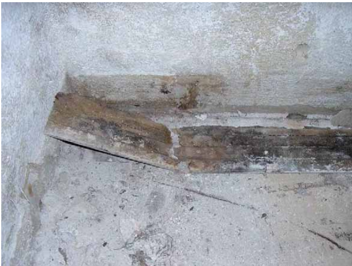
Abbildung 2-24: Foto 35: Sockelleiste aus großer Eingangshalle (EG), Feuchtigkeit
