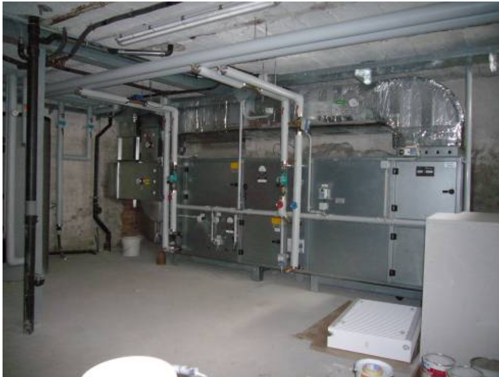
Bilder: Wärmerückgewinnung von Backofen, Lüftungsinstallationen, Lüftungsanlage
