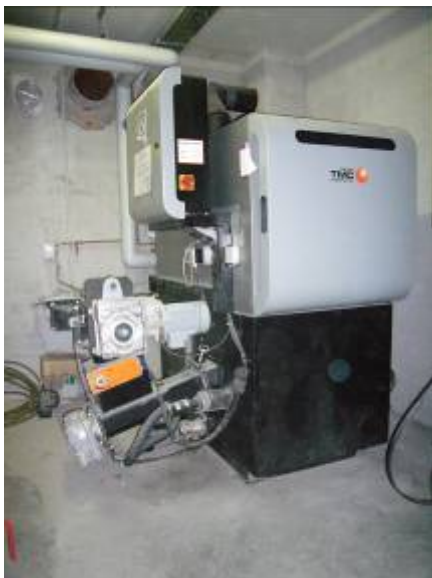
Bild: Pellettsheizung (Kessel)
