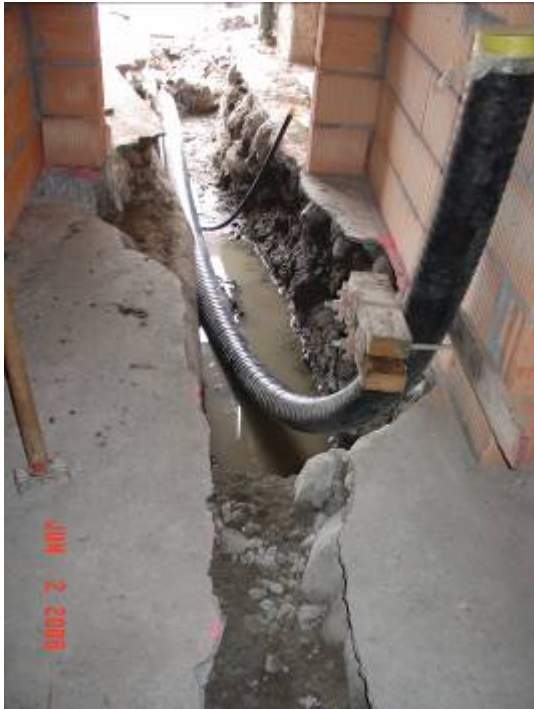
Bilder: Fernwärmeleitung Neben-/Haupthaus
