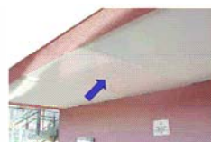
Durchgang Passivhaus mit Vakuumdämmung (blauer Pfeil)
