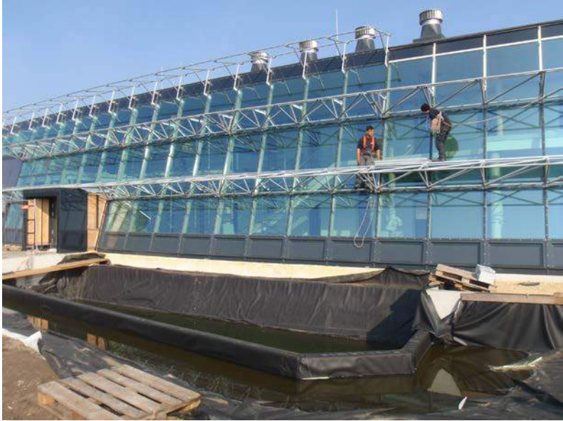
Abbildung 123:PV Unterkonstruktion auf der Fassade
