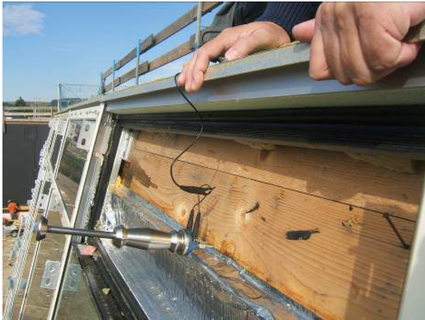
Abbildung 119: Feuchtemessung des Attikaträgers
