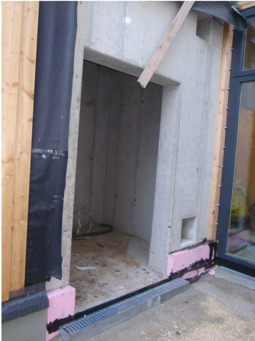
Abbildung 56: Batterieraum als Reservelfläche für spätere Nutzung
