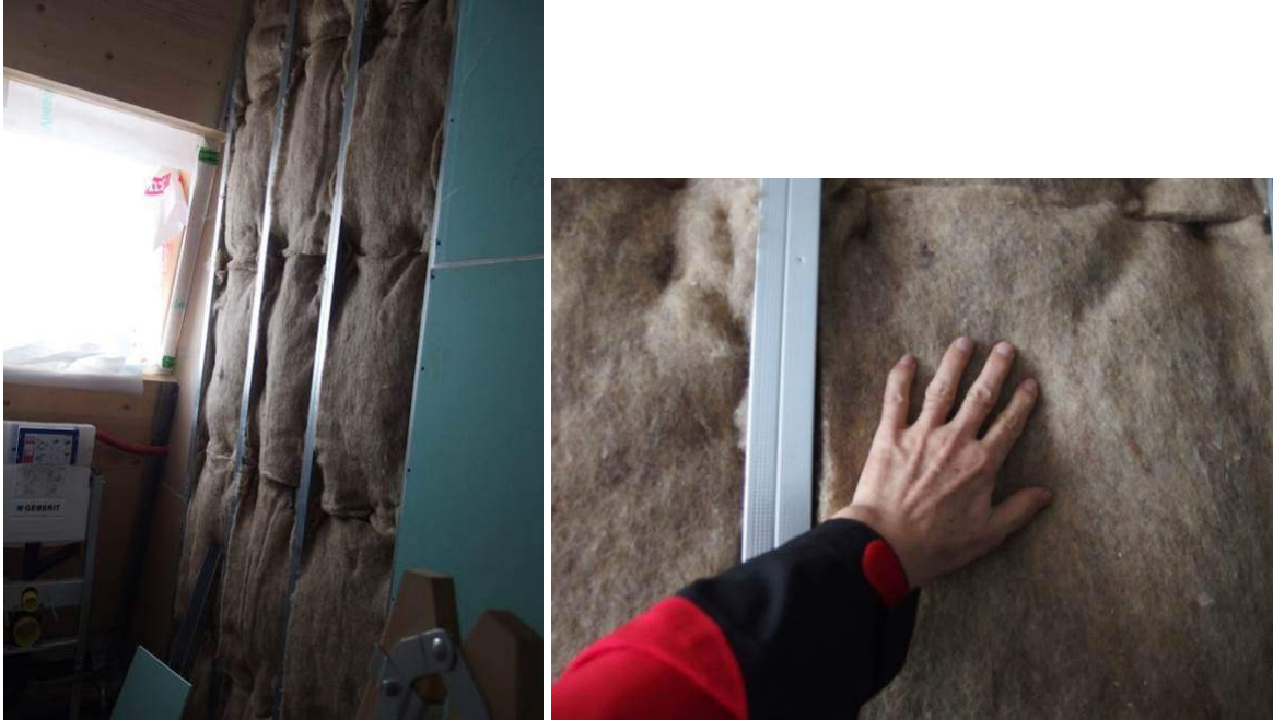
Abbildung 139: Schalldämmende Wand beim Chefzimmer
