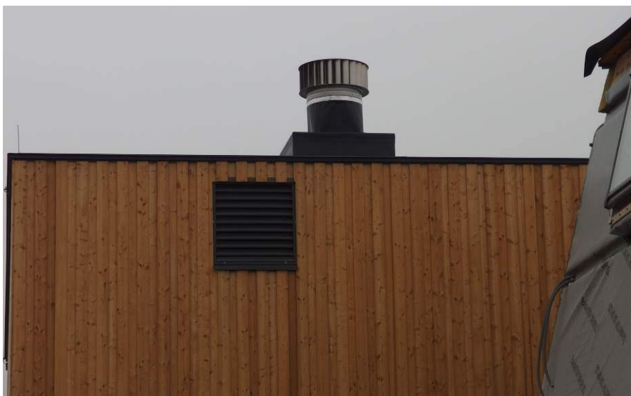
Abbildung 41: Windgenerator auf der Abluft der Lüftungsanlage in der Halle
