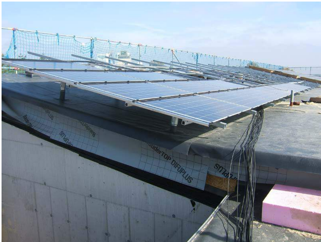
Abbildung 120: PV am Dach:
