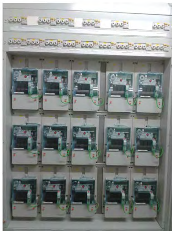
Zählerverteiler mit eingebauten Strom Smart Meter
