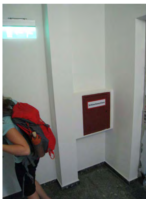
Trockensteigleitung im Stiegenhaus
