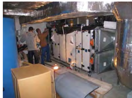
Zentrales Lüftungsgerät für den Altbau
