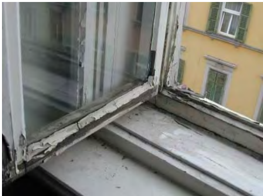
Verwitterung bei Holzrahmenfenstern
