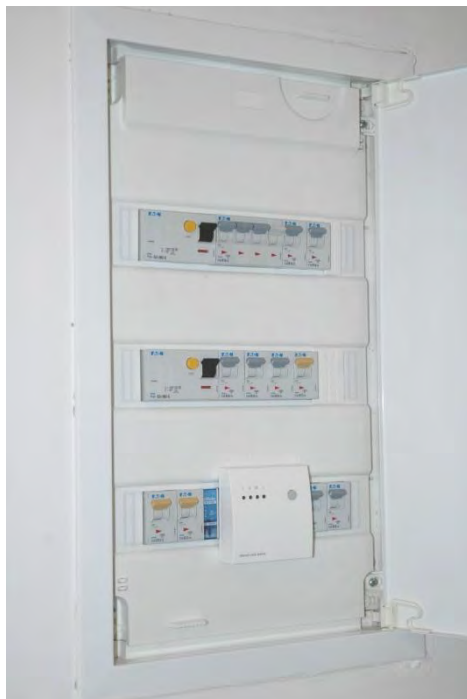
Abb. 4.: Elektroverteiler mit Lüftungssteuerung
