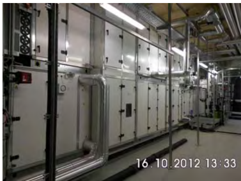
Abbildung 13: DEC Lüftungsgerät in der Technikzentrale aspern IQ
