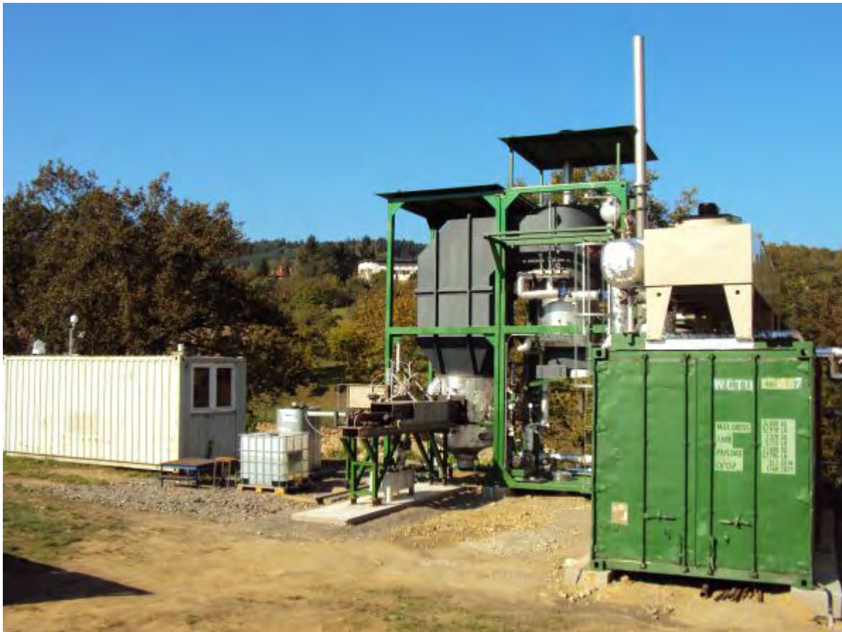
Abb. 2: Energiezentrale 400+ im Probebetrieb am Standort Leiben
