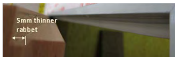
Abbildung 42: Foto des oben um 5mm abgefrästen Türfalzes. Über den verbleibenden Spalt zwischen Falz und Türdichtung kann die Luft überströmen.
